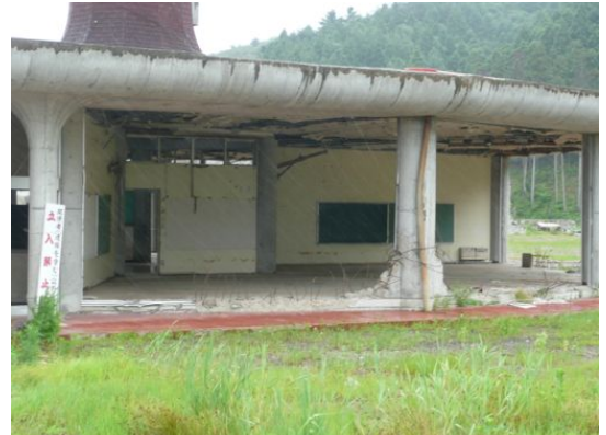
▲この地域の避難所に指定されていた石巻市立大川小学校。瓦礫は片付けられていたが、黒板の存在からおそらく教室だったと思われるところ。
