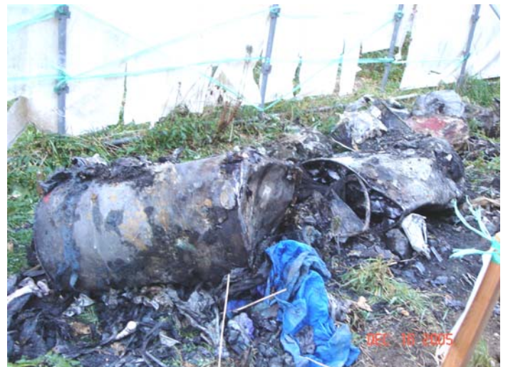
▲処分場西側の平坦部の掘削で、12/16～12/22までの間に計105本のドラム缶、65本の18L缶が発見され、内容物は黒い油のような物体が入っていました。
